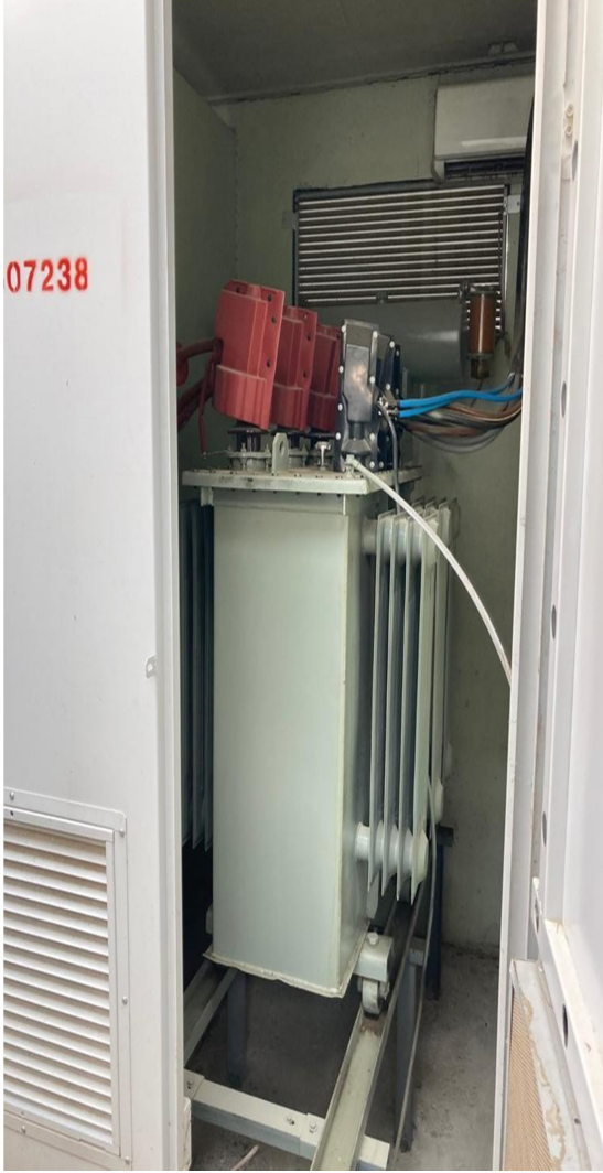
10,5 kV Eski Trafo
